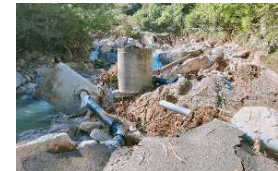
丸森町石羽浄水場の取水口流出
