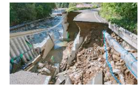
丸森町の道路崩落等によるアクセス路(県道)被災
