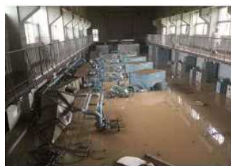
浸水被害を受けたポンプ施設
