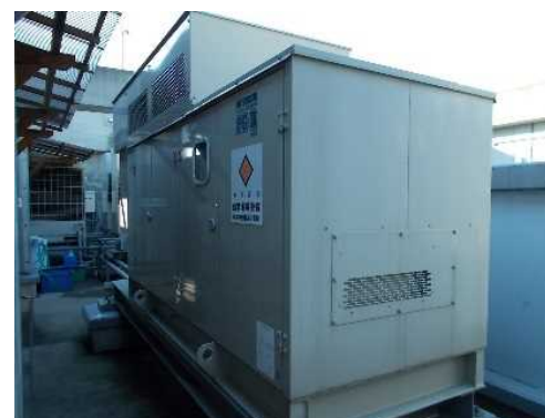
(非常用自家発電装置)
