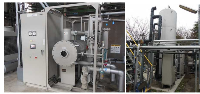
工場排水の浄化のために導入されたオゾン発生装置（千葉県野田市）
