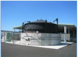
バイオガス発電
