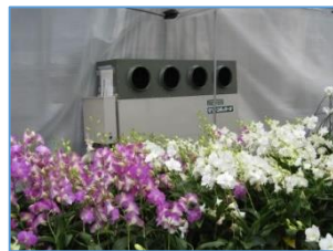
安定的採熱とヒートポンプ利活用
