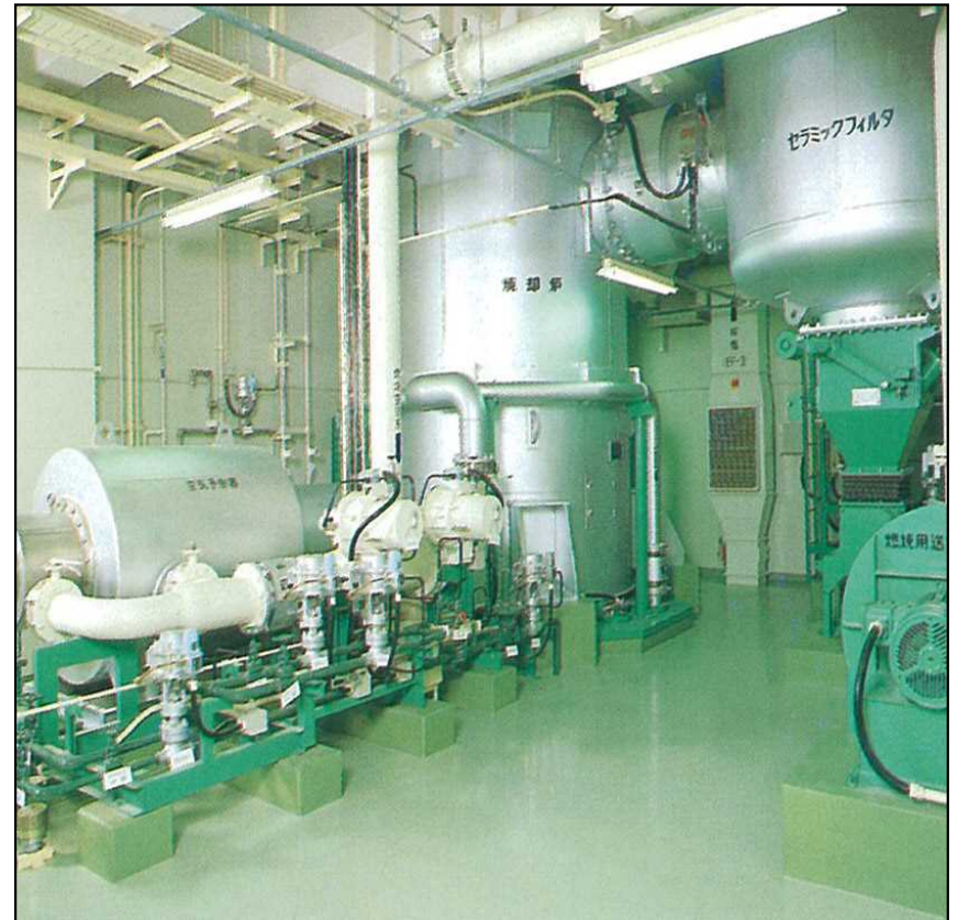
■ 焼却処理設備
