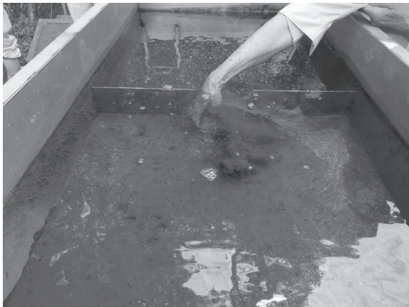
写真4 簡易緩速ろ過装置（高知県大豊町津家地区）奥が砂利層。手前は砂層であり表層に泥が蓄積している。
