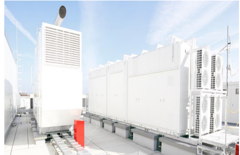
自家発電設備
