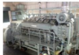
例：自家発電機の整備
