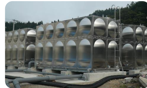
<写真-4 仮設タンク >
