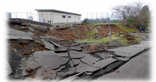
穴水町内の地割れ被害の状況
