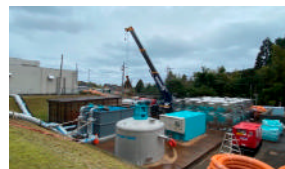
可搬式浄水装置設置 (提供：名古屋市上下水道局)
