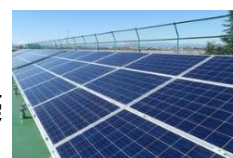
太陽光パネル
