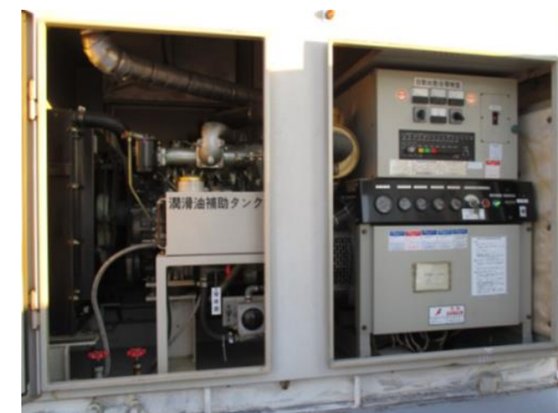
<自家発電設備>
